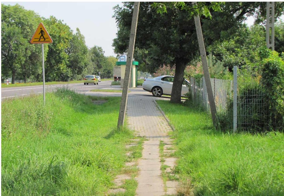
Rysunek 2. Droga dla rowerów i pieszych wzdłuż DK 2, Ołtarzew. Niezachowane warunki techniczne dotyczące szerokości, nawierzchni, skrajni i widoczności.
